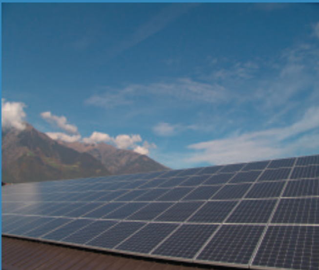
0,6 MWp Meran (Italien) 2.600 Module SOLARWATT M230-96 GET AK
