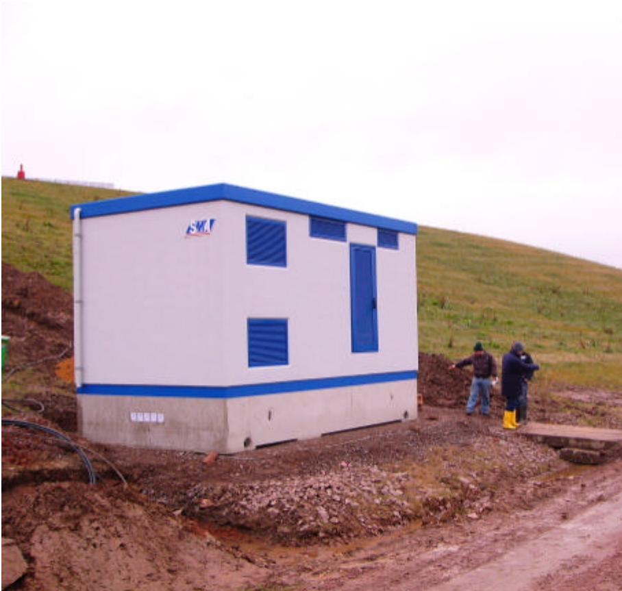
Außenansicht Kompaktstation Wechselrichter/Trafo
