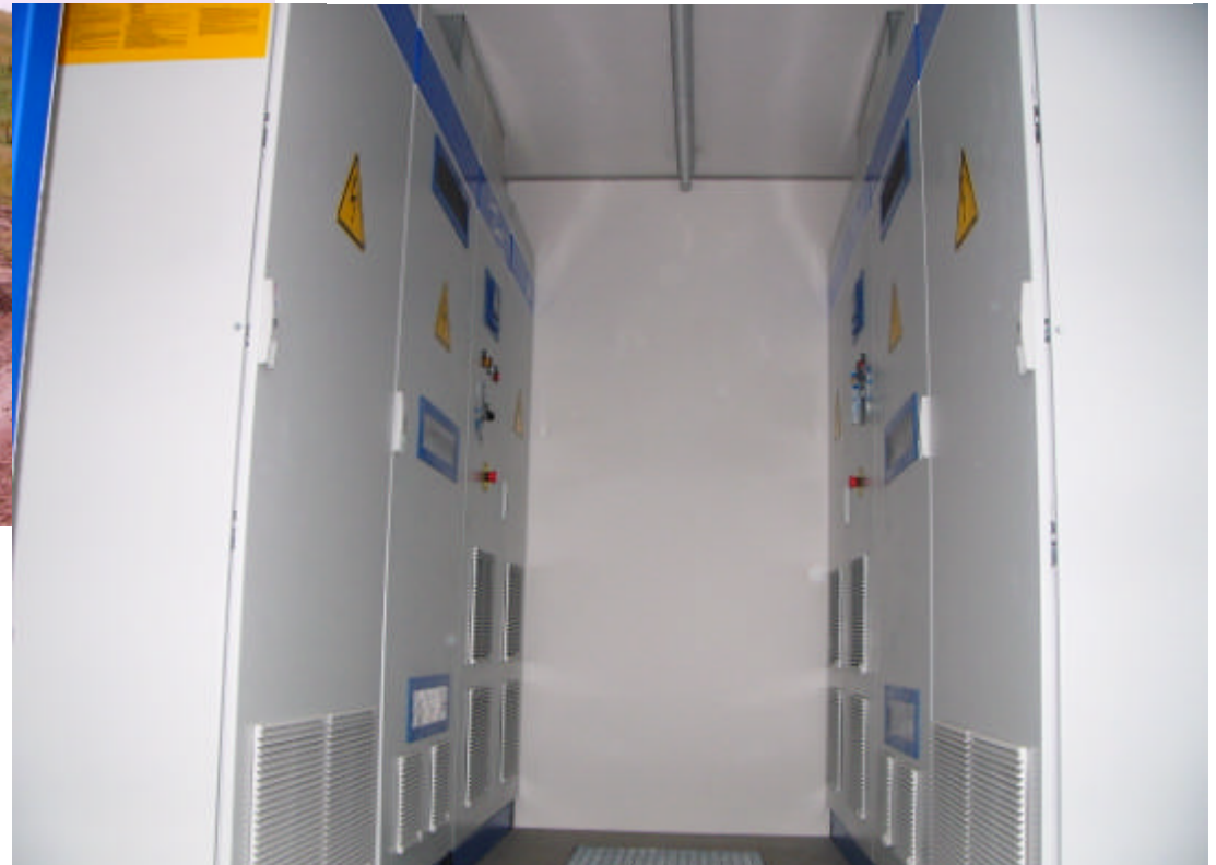
Ansicht: Innenraum Wechselrichter SMA SC 1000 MV
